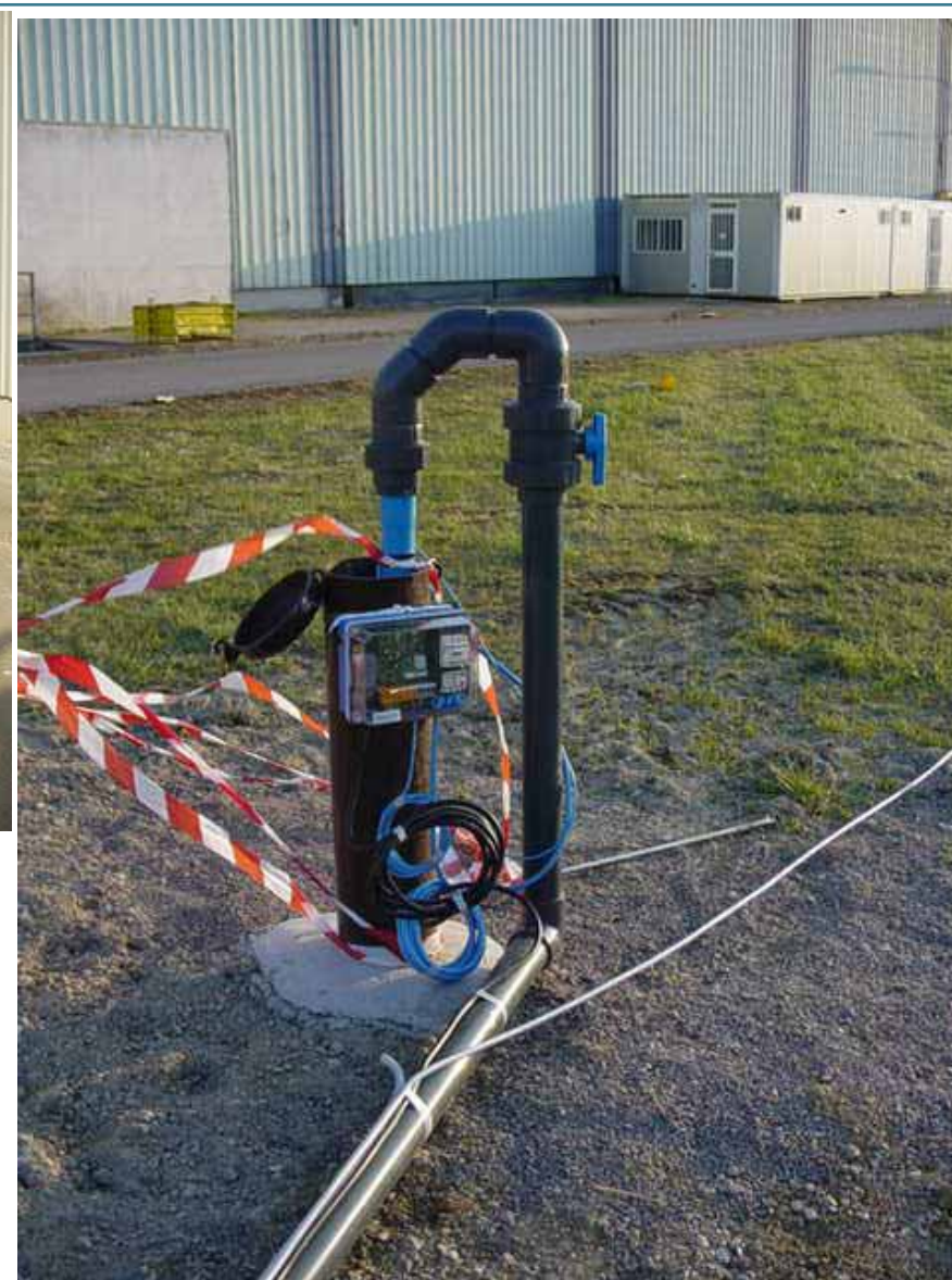
Puits de récupération équipé
